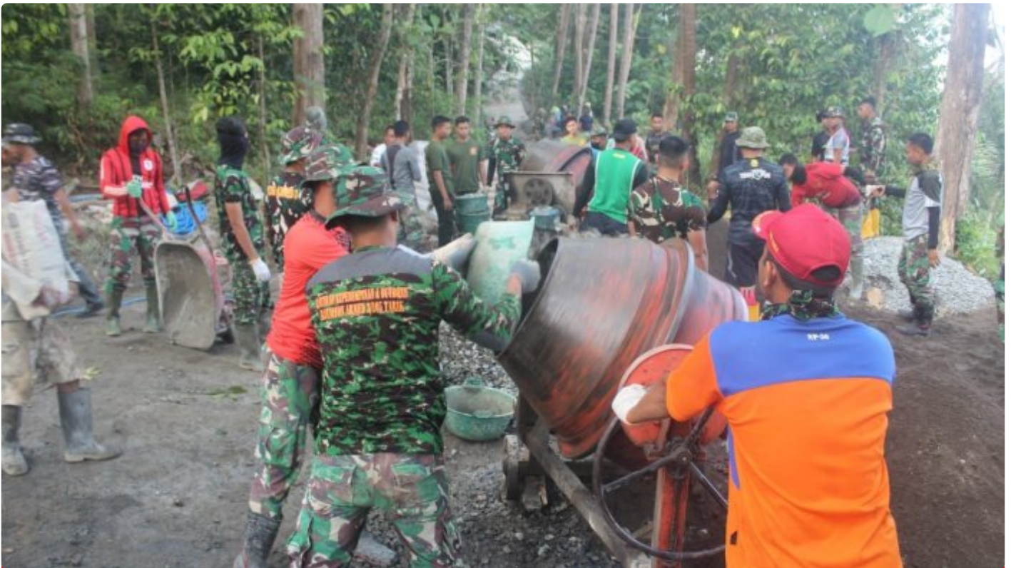
Satgas TMMD Reguler Ke-116 Kodim 0709/Kebumen Bersama Warga terus Pacu Pembangunan Rabat Beton
