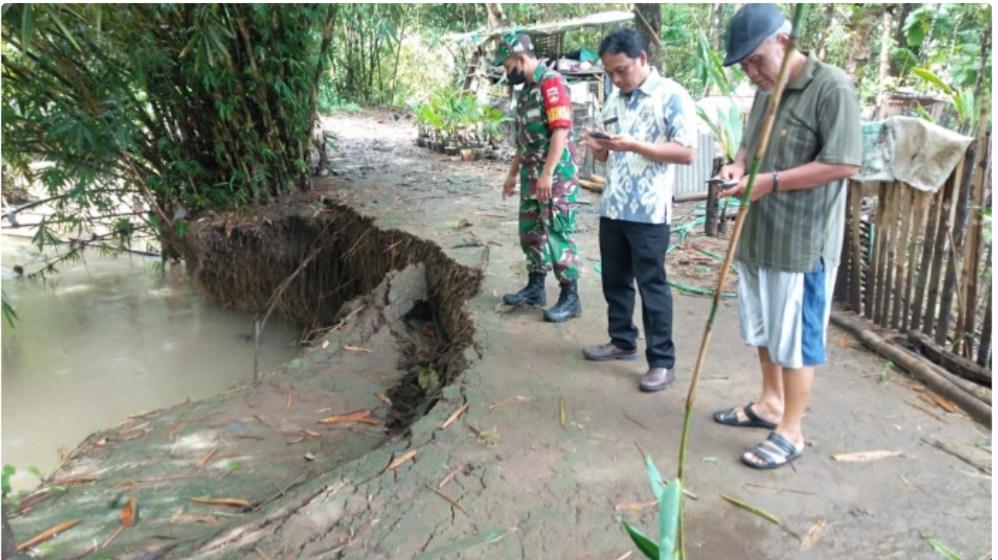
Serda Nur Arifin cek Lokasi tanggul sungai Sirago Amblas di wilayah Dusun Ingas RT 02/05 Desa Sruweng
